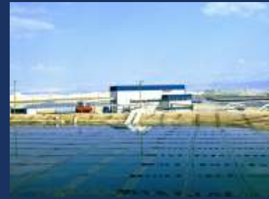
1975 חזרה לאנרגיית השמש תחנת כח 5 MW בבית הערבה
